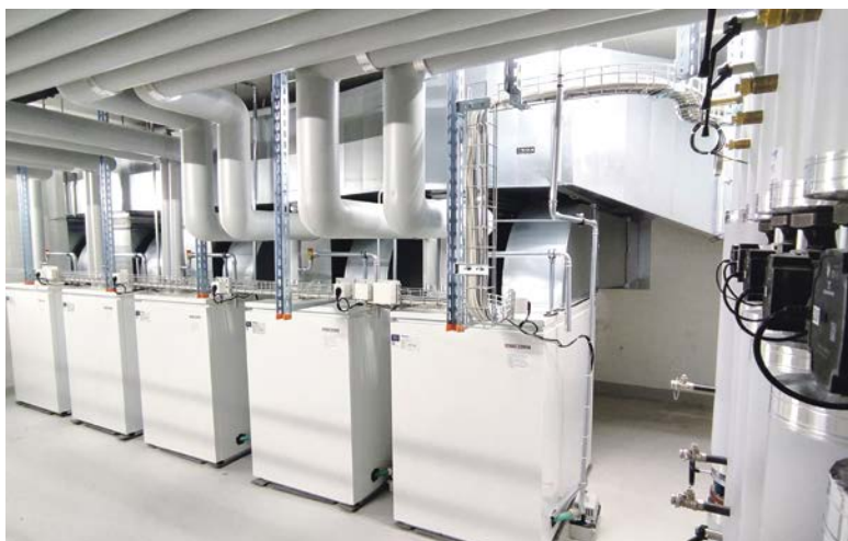
Wärmepumpen im Haus 1.
