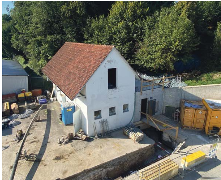
Die neue Verteilzentrale für die Gasversorgung (Rohbau rechts) ist bereits gebaut. Im Herbst wird das weisse Gebäude abgebrochen, um Platz für die Energiezentrale zu schaffen.
